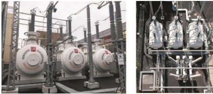
Рис. 1. Вид ВТСП ТОУ, установленного на ПС 220 кВ Мневники
