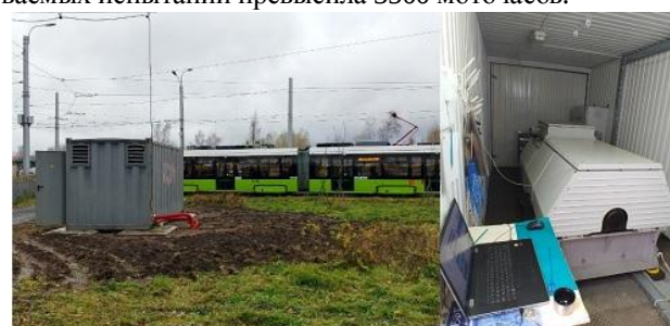
Рис. 2. Контейнер с накопителем энергии НКЭ-3Г во время работы в КС трамвая (а); внешний вид накопителя (б)
