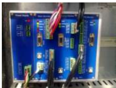
Рис. 6. Системы диагностического мониторинга трансформаторного оборудования: TIM-3 (а) и TDM P034 (б) РЕЗУЛЬТАТЫ ИССЛЕДОВАНИЙ
